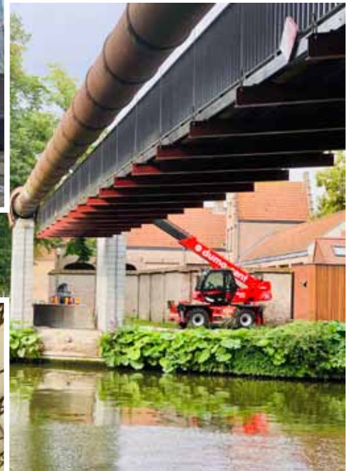
Manitou MRT1840 Dringende interventie defecte brug @Brugge
